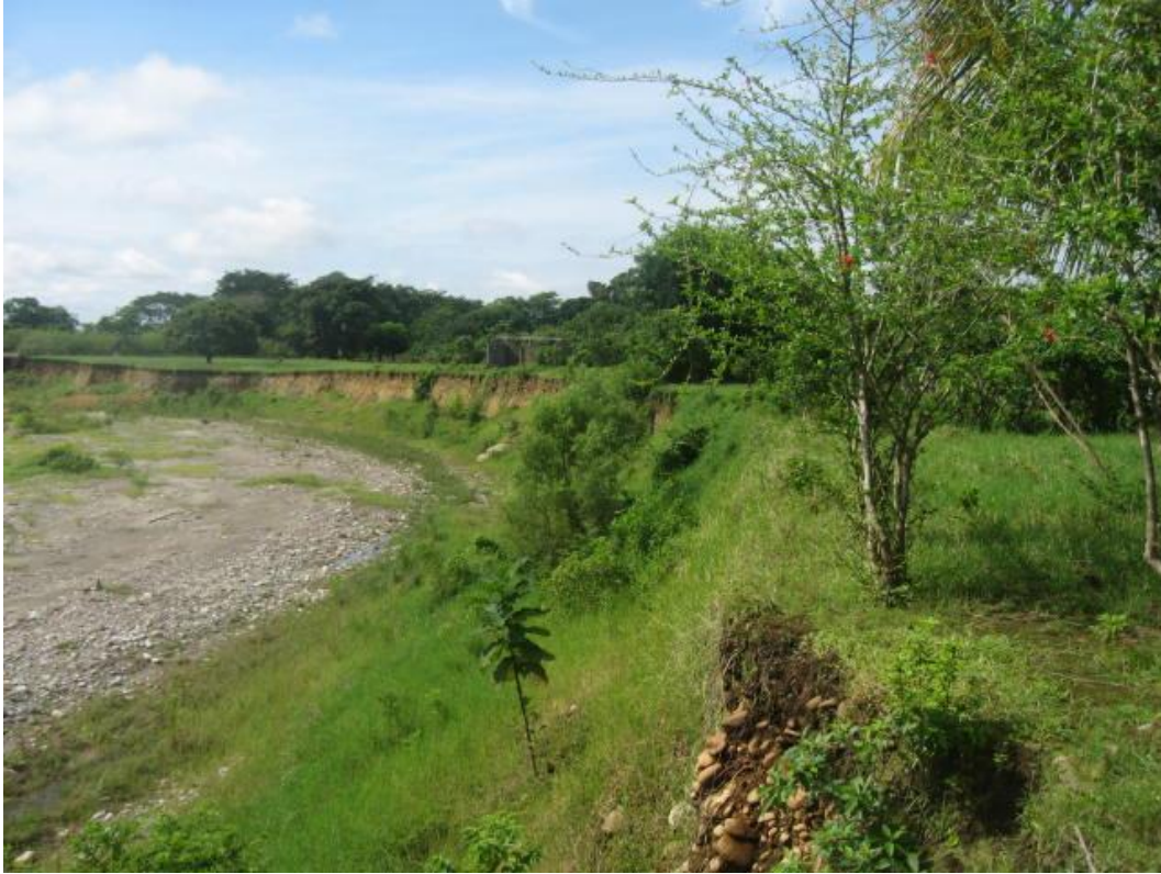
Fotografía No. 2.28).- Ranchería Harbin, punto AC-071, observe en la margen derecha como el río Grande deslavó las paredes hasta con 2 m de altura.
