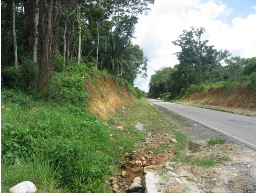
Fotografía No. 2.12.- Punto de control de deslizamiento (AC-046) localizado a 3.7 Km. al poniente de la ciudad de Acacoyagua, a un costado de la carretera federal No. 200 Arriaga-Tapachula, en el paraje conocido localmente como parada La Cadena.
