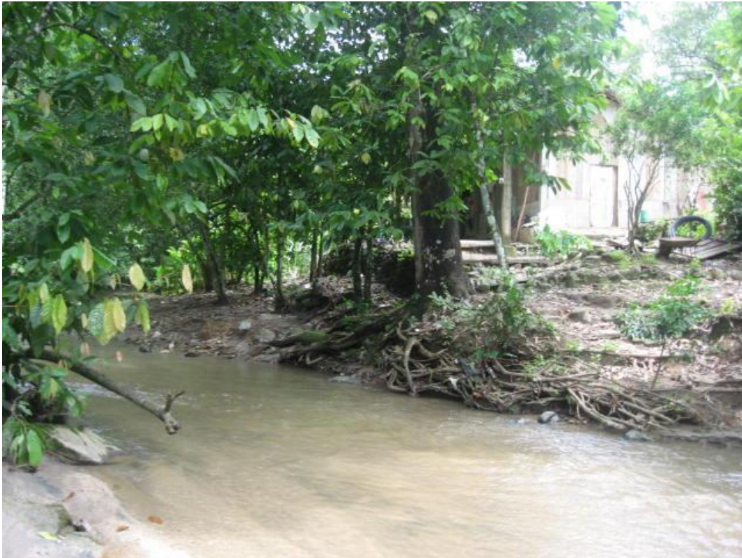
Fotografía No. 2.16.- Punto localizado en el Ejido San Pedro AC-013, en dirección a la vivienda, observe el corte que hizo el agua durante el desbordamiento de octubre de 2005.
