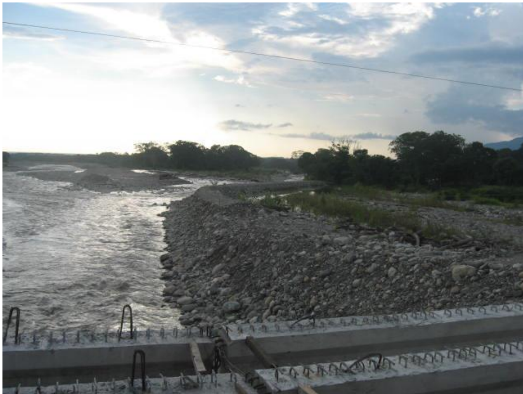
Fotografía No. 2.26).- Puente Cintalapa, a 200 m al SW de Playa Inés Sección Uno, AC-069, observe el ancho del río Cintalapa y la altura de los bordos.
