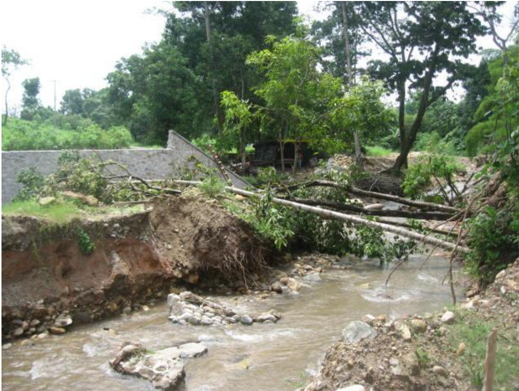
Fotografía No. 2.17.-Barrió Morelos I, puente que comunicaba al ejido San Pedro AC-014. Sobre la corriente se observan árboles derribados y al frente el corte que hizo el agua al cauce durante los desbordes de octubre de 2005.
