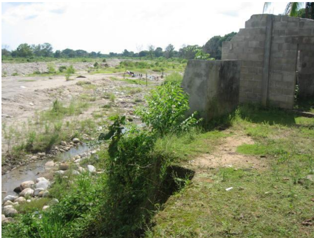
Fotografía No. 2.24).- Av. Constitución esquina con Alberto Montaña, Punto AC-063. En este punto el río Grande se amplió hasta 450 m, destruyó viviendas tal como se observa en esta fotografía.
