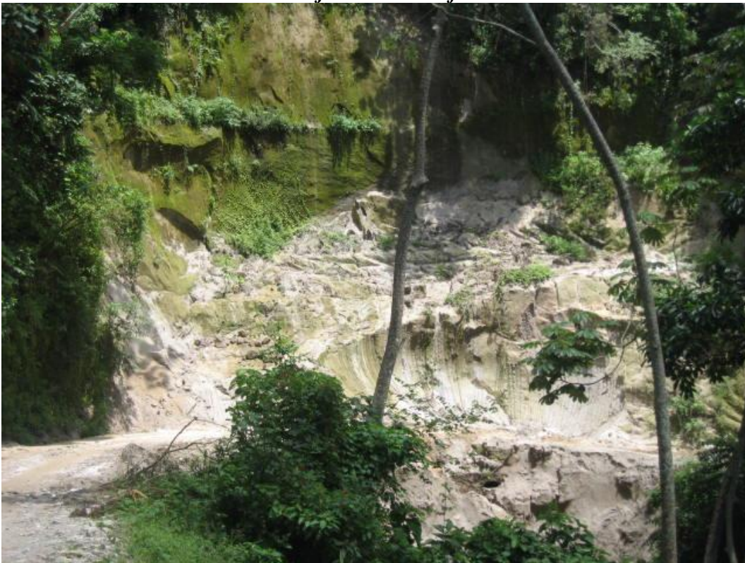
Fotografía No. 2.10.- Punto de control por deslizamiento (AC-033) localizado a 750m al norte de Las Magnolias.
