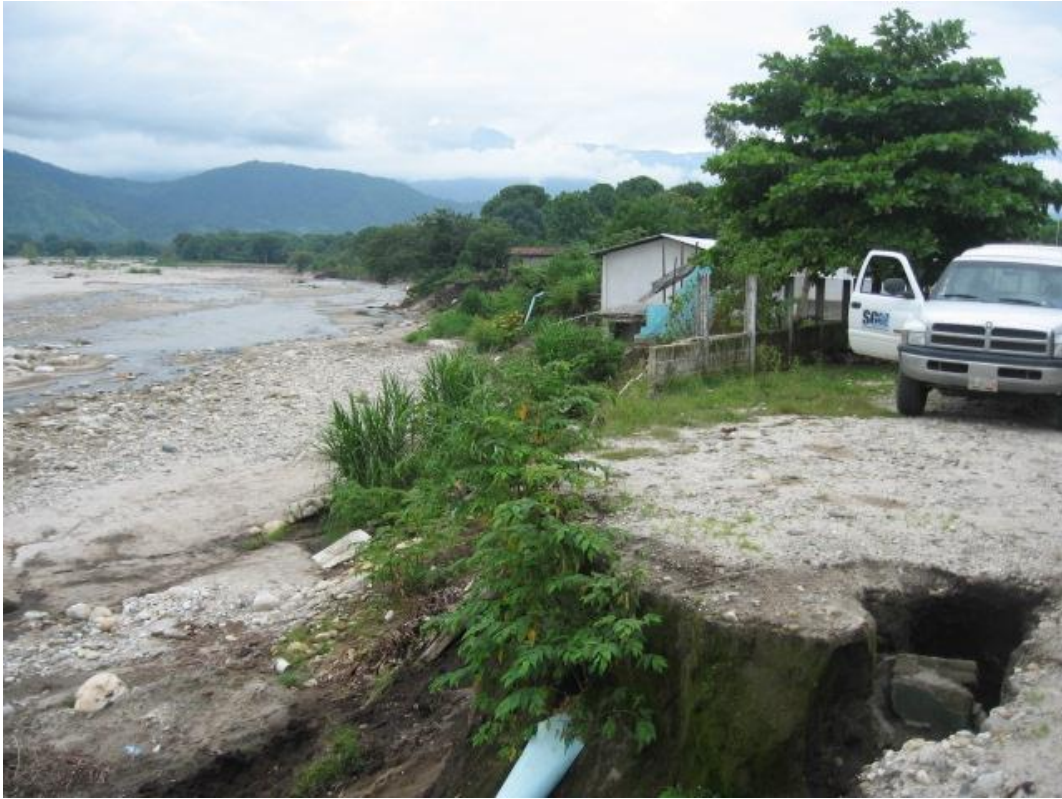
Fotografía No 2.5.- Erosión antropogénica asociada a crecimiento urbano AP-112.
