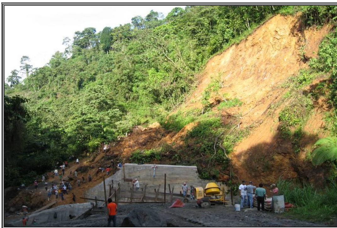
Fotografía No 2.5.- Deslizamientos sobre el camino que conduce al poblado de Toquían Municipio de Cacahoatán.
