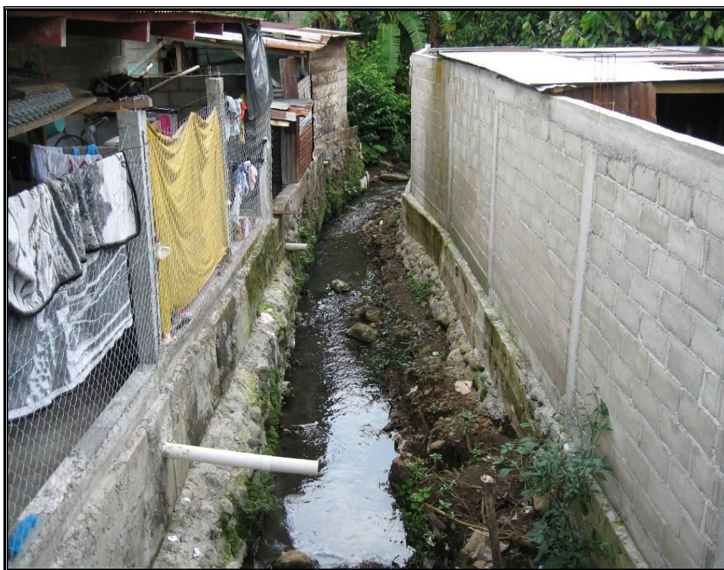
Fotografías No. 2.12.- Afectación por inundación en viviendas ubicadas sobre las márgenes de arroyos intermitentes ubicados en la Ciudad de Cacahoatán.
