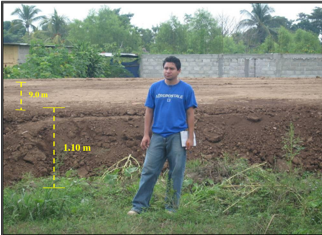
Fotografía No. 2.12.- Condiciones actuales en que se encuentra el nuevo bordo.
