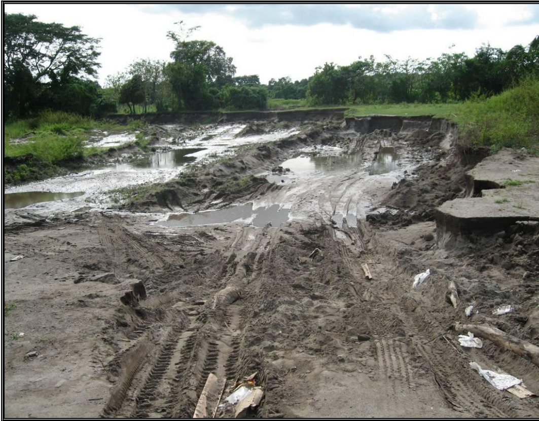
Fotografía No. 2.17.- Extracción de material en las zonas de inundación del Río Suchiate aledañas al poblado Ignacio Zaragoza.
