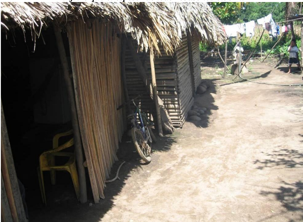
Fotografía No.2.29.- Afectaciones a las viviendas que se ubican en la colonia El Pelón (sobre el camino de terracería que une a la colonia Cuauhtémoc con la carretera Ciudad Hidalgo-Puerto Madero) donde el nivel del agua subió 1.20 m.
