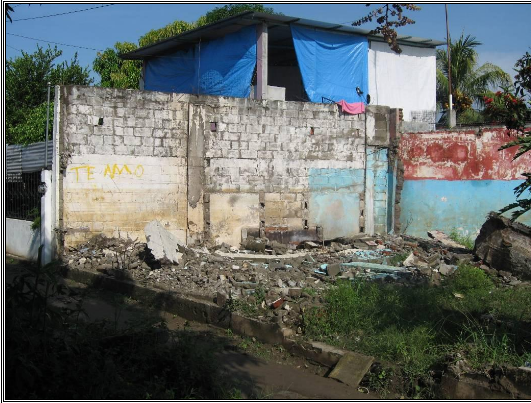
Fotografía No. 2.7.- Vivienda con afectación mayor la cual fue destruida por ser familia reubicada en la Colonia Belisario Domínguez.
