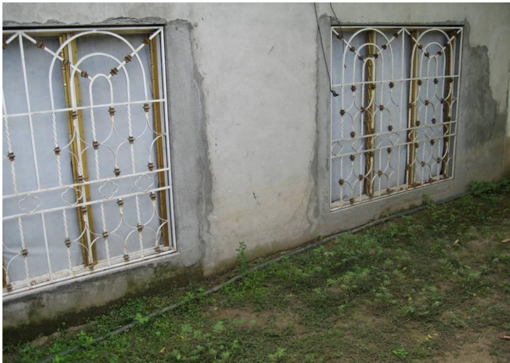
Fotografía No. 2.28.- Afectaciones a las viviendas que se ubican en la colonia Jesús Carranza (en el centro de la misma) donde el nivel del agua subió 0.87 m. y donde se infiere que el espesor de lodo rebasó los 0.50 m.
