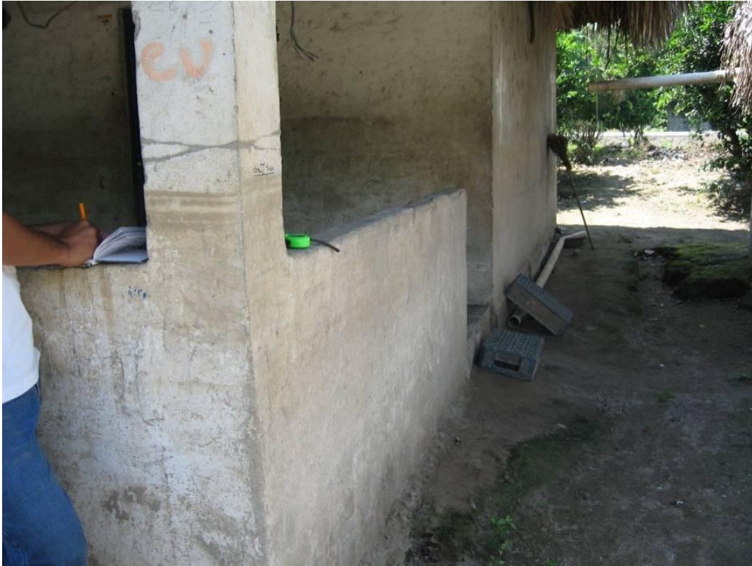
Fotografía No. 2.26.- Afectaciones a las viviendas que se ubican en la colonia Ignacio López Rayón (sobre la carretera La Libertad-Ciudad Hidalgo) donde el nivel del agua subió 1.39 m.
