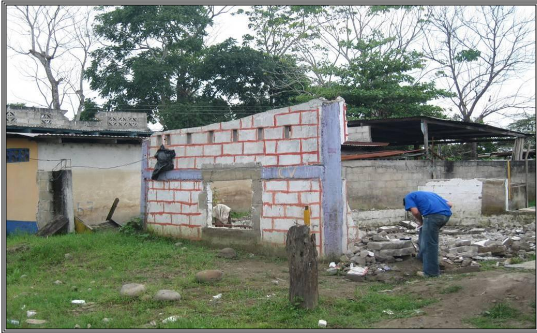
Fotografía No. 2.8.- Vivienda ubicada entre las calles # 7 y la Av. Belisario Domínguez de la Colonia del mismo nombre, durante las inundaciones del 2005, el agua alcanzó 1.57 m de alto y el espesor del sedimento fue de 1.43 m
