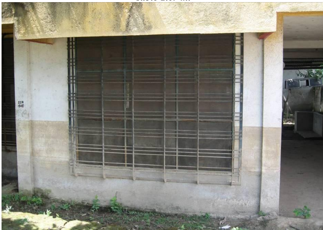
Fotografía No. 2.25.- Afectaciones a las viviendas que se ubican en la colonia Ignacio López Rayón en su porción oriente (a 150 m. del punto anterior) donde el nivel del agua subió 1.09 m.
