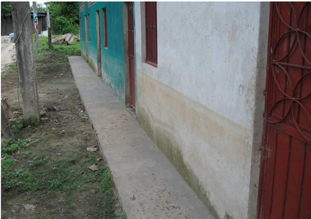
Fotografía No. 2.27.- Afectaciones a las viviendas que se ubican en la colonia Jesús Carranza (en el centro de la misma) donde el nivel del agua subió 0.87 m.
