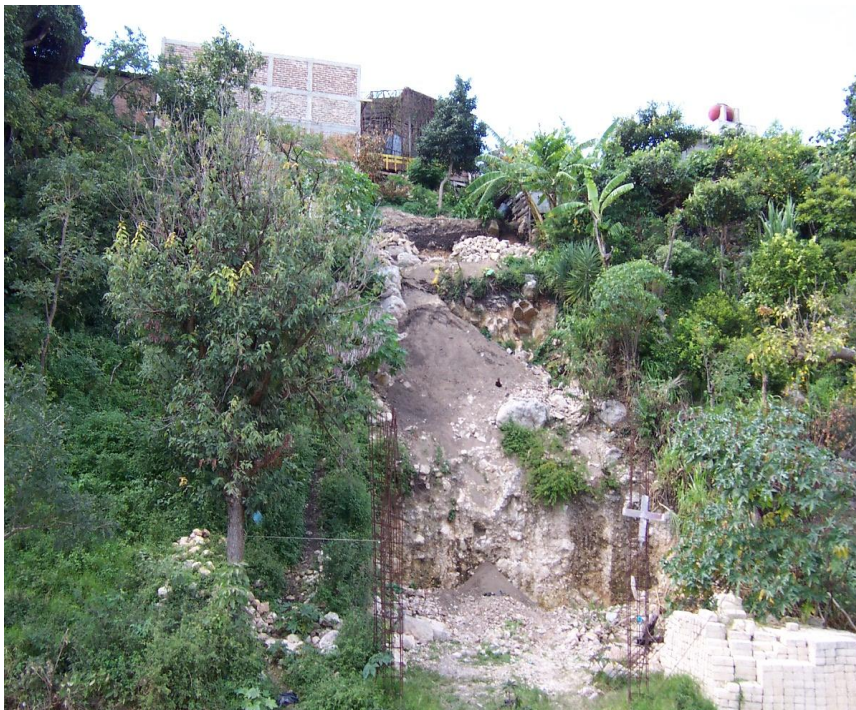
Fotografía,5 Deslizamiento de rocas y suelo, producto del crecimiento urbano, Barrio San Miguel.
