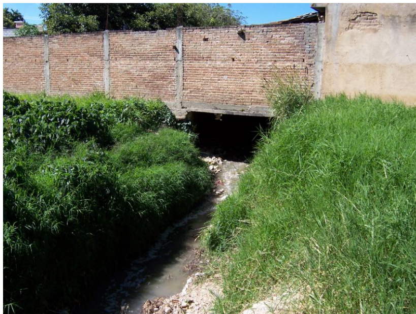
Fotografía 12. Obsérvese la construcción de algunas casas sobre el cauce de un arroyo, utilizándolo como desembocadura del drenaje de la zona urbana (Barrio Yalchivol).
