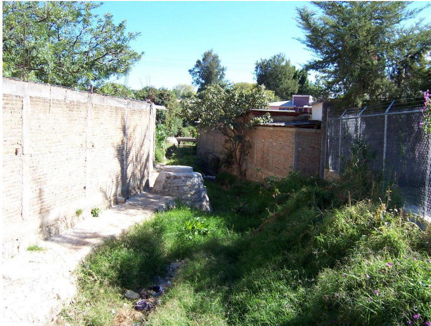
Fotografía 13 . Obsérvese la construcción de algunas casas sobre el cauce de un arroyo, utilizándolo como desembocadura del drenaje de la zona urbana (Barrio 20 de Noviembre).
