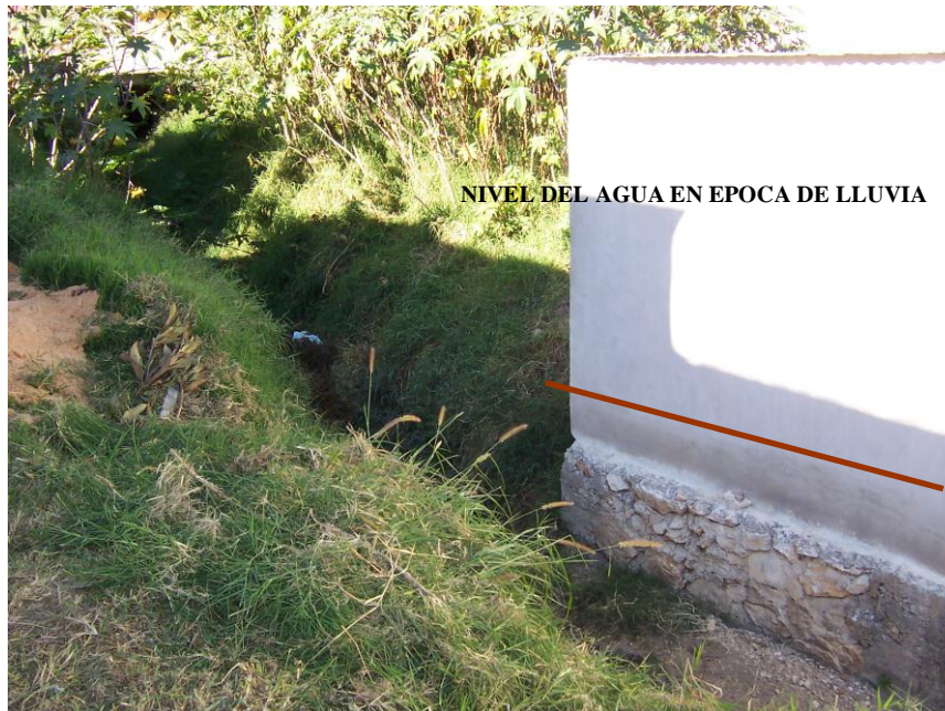
Fotografía 11 . Obsérvese la construcción de casa sobre el cauce de un arroyo (Barrio Belisario Domínguez)
