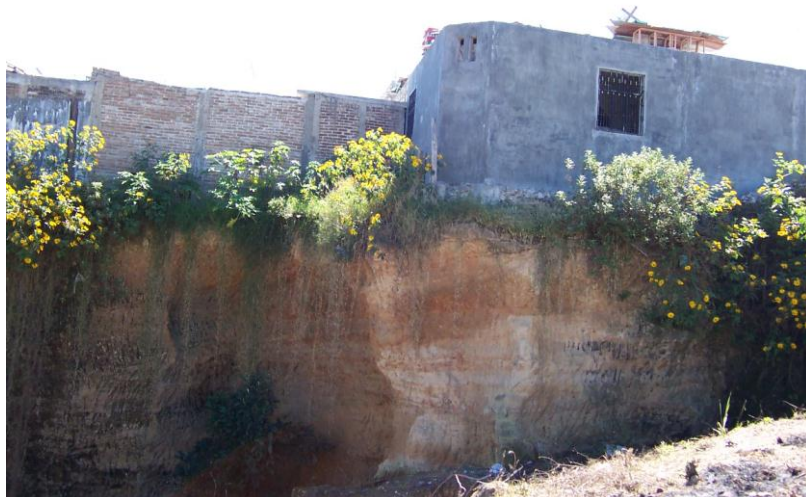
Fotografía 8. Erosión Antropogénica, por extracción de material para la elaboración de ladrillos, obsérvese el asentamiento urbano en riesgo por esta actividad, oquedades sin algún tipo de protección (Barrio Belisario Domínguez)
