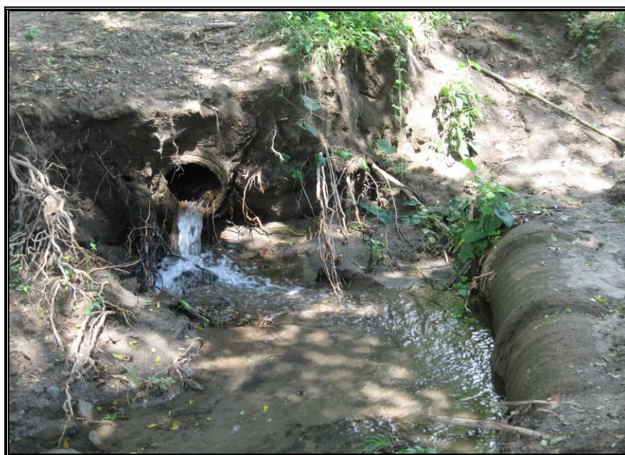
Fotografía 2.4.- Vertido de aguas residuales a arroyos ubicados en el municipio de Frontera Hidalgo.
