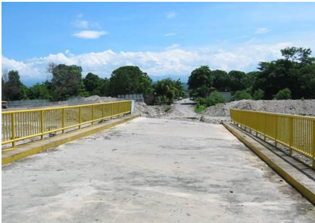
Fotografía 2.83.- Daños en un puente vehicular por el paso de la corriente. Obsérvese la inclinación del puente.
