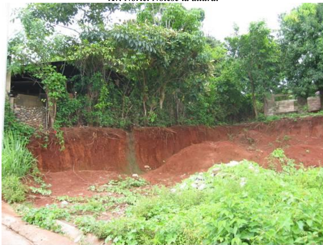
Fotografía 2.19.- Viviendas expuestas a peligro alto por deslizamiento, ubicada sobre la 1ª Av. Poniente. Nótese la ubicación de las mismas
