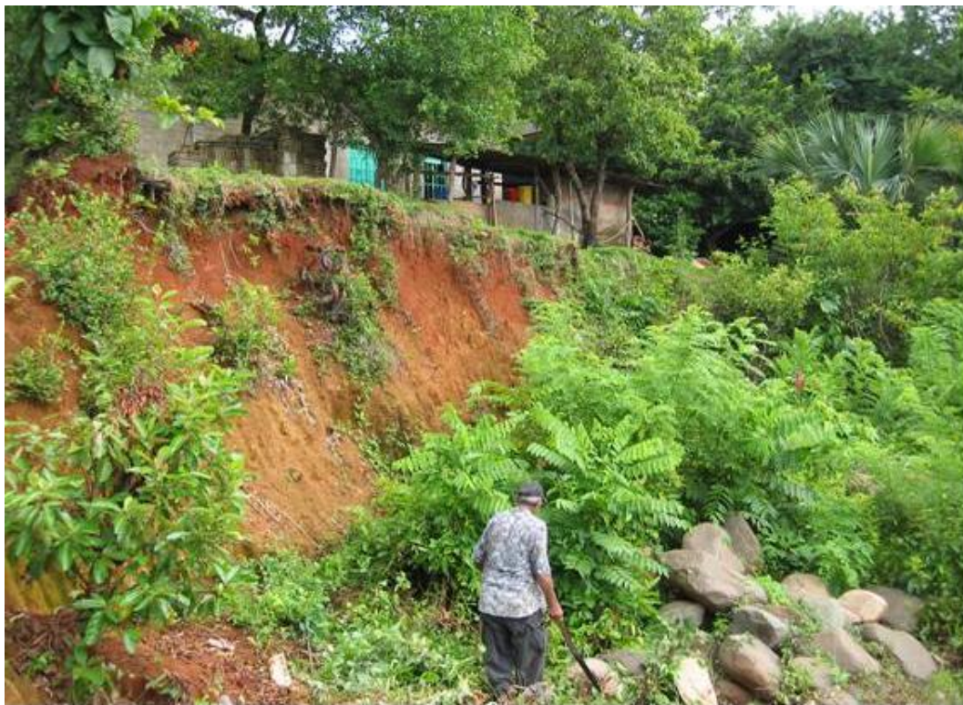
Fotografía 2.18.- Vivienda expuesta a peligro alto por deslizamiento, ubicada sobre la 4ª Av. Norte. Nótese la altura.
