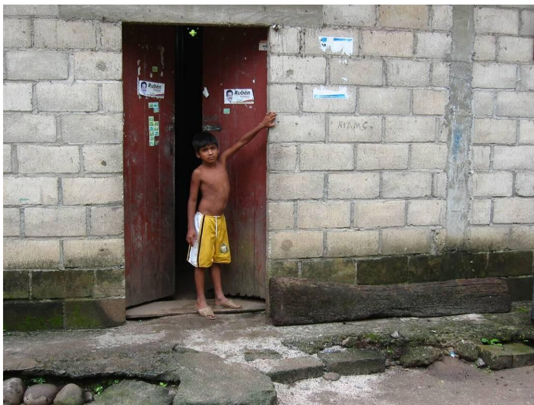
Fotografía 2.50.- Poblado San José El Amate. Obsérvese hasta donde llegó el nivel de agua
