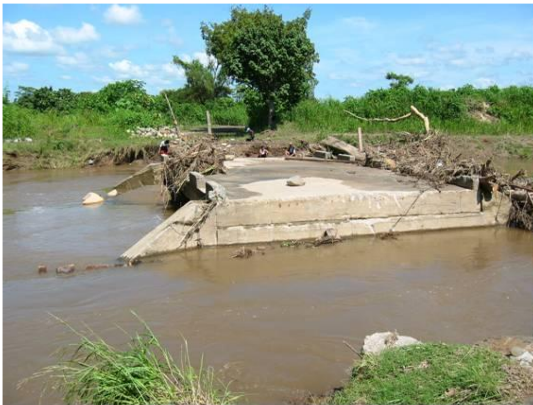
Fotografía 2.36.- Destrucción de puente debido a la fuerza de la corriente del Río Cuyamiapa. Obsérvese los restos de material vegetal producto del arrastre.
