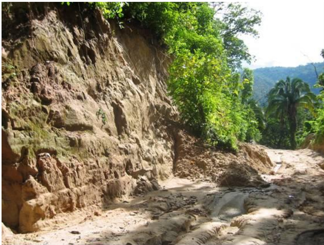
Fotografía 2.11.- Afectación por flujo de detritos, caída de materiales no consolidados y erosión hídrica por escurrimientos formando canalillos sobre el camino que comunica a la población Las Delicias.
