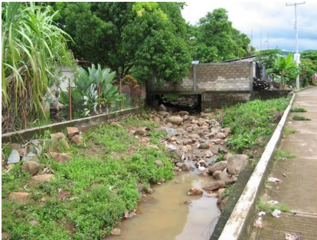
Fotografía 2.63.- Arroyo ubicado sobre la calle 2ª Poniente. Nótese la presencia de basura sobre el arroyo
