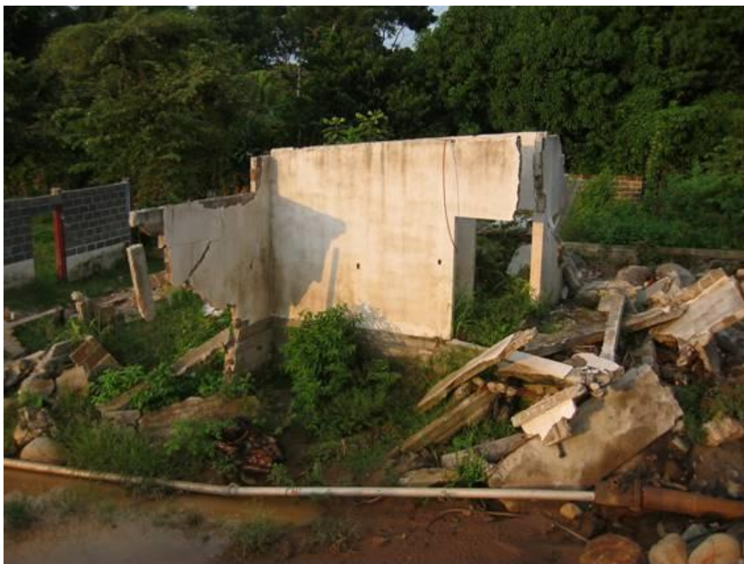
Fotografía 2.69.- Vivienda ubicada sobre la margen derecha destruida por el paso de la corriente. Nótese el grado de afectación
