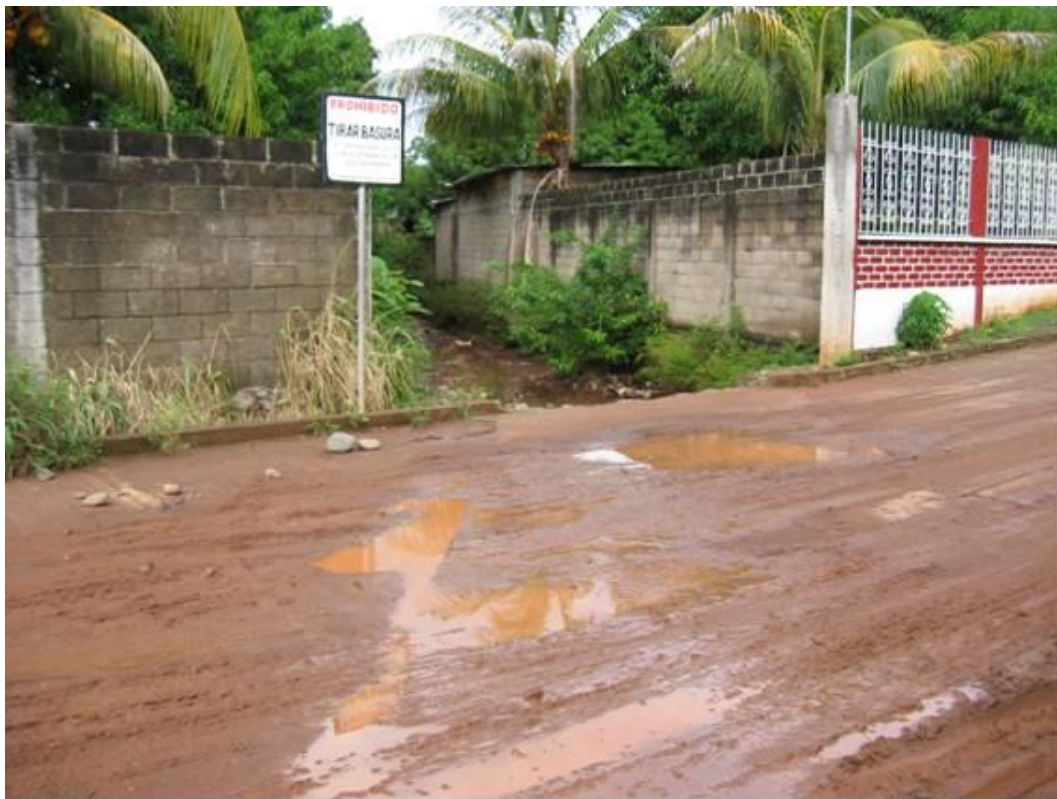
Fotografía 62.- Arroyo ubicado en la calle 3ª Poniente. Nótese la ubicación de los muros de las viviendas.
