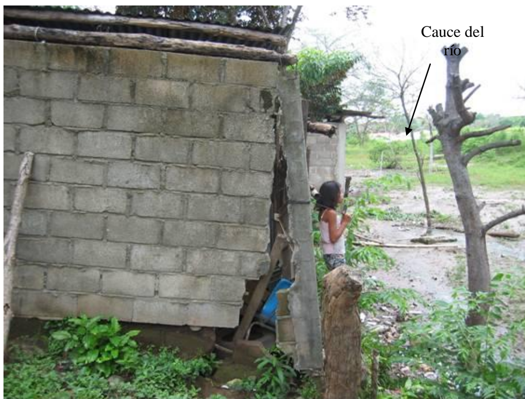
Fotografía 2.90.- Viviendas dañadas por asentamiento del terreno en la calle Javier Mina, obsérvese la ubicación del cauce del río.
