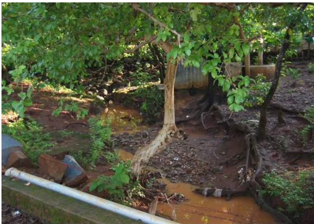
Fotografía 2.59.- Barrio Santo Domingo viviendas expuestas a peligro alto por inundación Obsérvese la ubicación de las viviendas con respecto al arroyo
