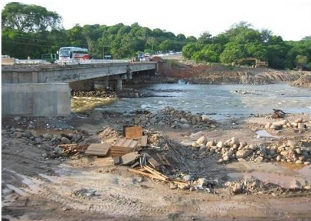
Fotografía 2.46.- Margen izquierda del Río Huehuetán sobre la carretera costera. Obsérvese la destrucción parcial del puente por el paso de la corriente.
