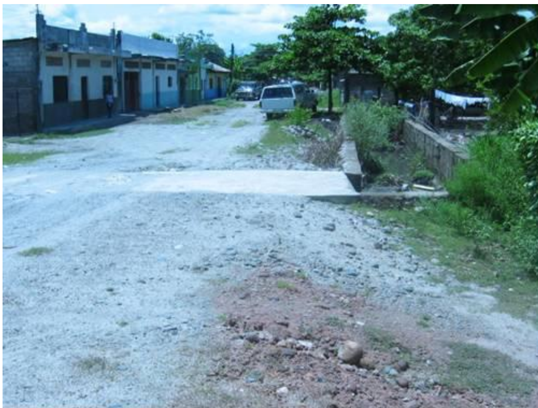
Fotografía 2.93.- Arroyo que cruza la calle Emiliano Zapata. Nótese la ubicación de las viviendas.
