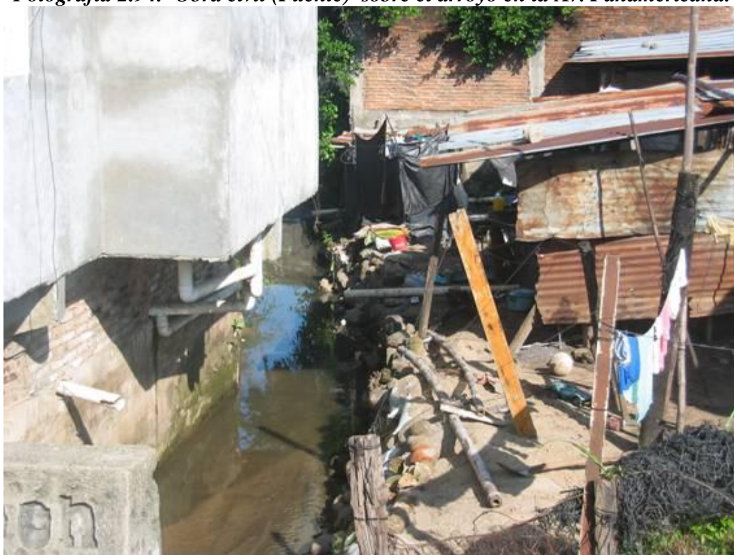
Fotografía 2.95.- Vivienda ubicada sobre la Av. Panamericana. Nótese la ubicación de la vivienda sobre el arroyo
