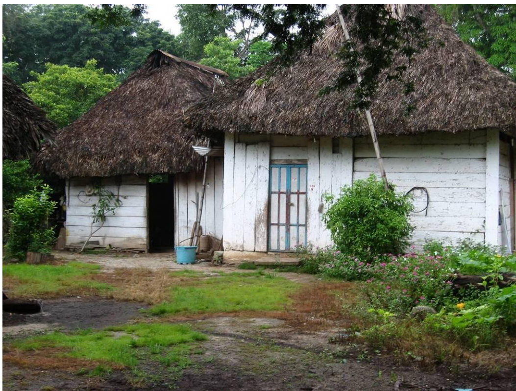
Fotografía 2.52.- Poblado Plan de Ayala. Obsérvese hasta donde llegó el nivel de agua en la vivienda
