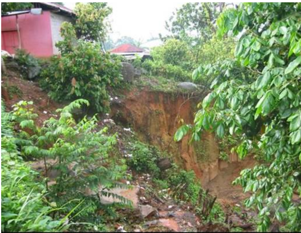
Fotografía 2.10.- Construcción expuesta a colapsarse, debido a la inestabilidad de la ladera. Nótese el escarpe que tiene 4 m de altura
