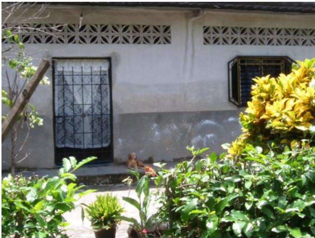
Fotografía 2.37.- Evidencias de afectación por inundación en el Cantón Alianza para la Producción. Obsérvese las marcas de agua.
