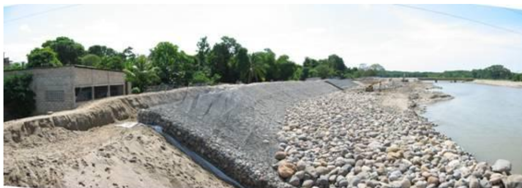
Fotografía 2.86.- Obras de mitigación sobre las márgenes del río Huehuetán. Nótese la ubicación de las viviendas.
