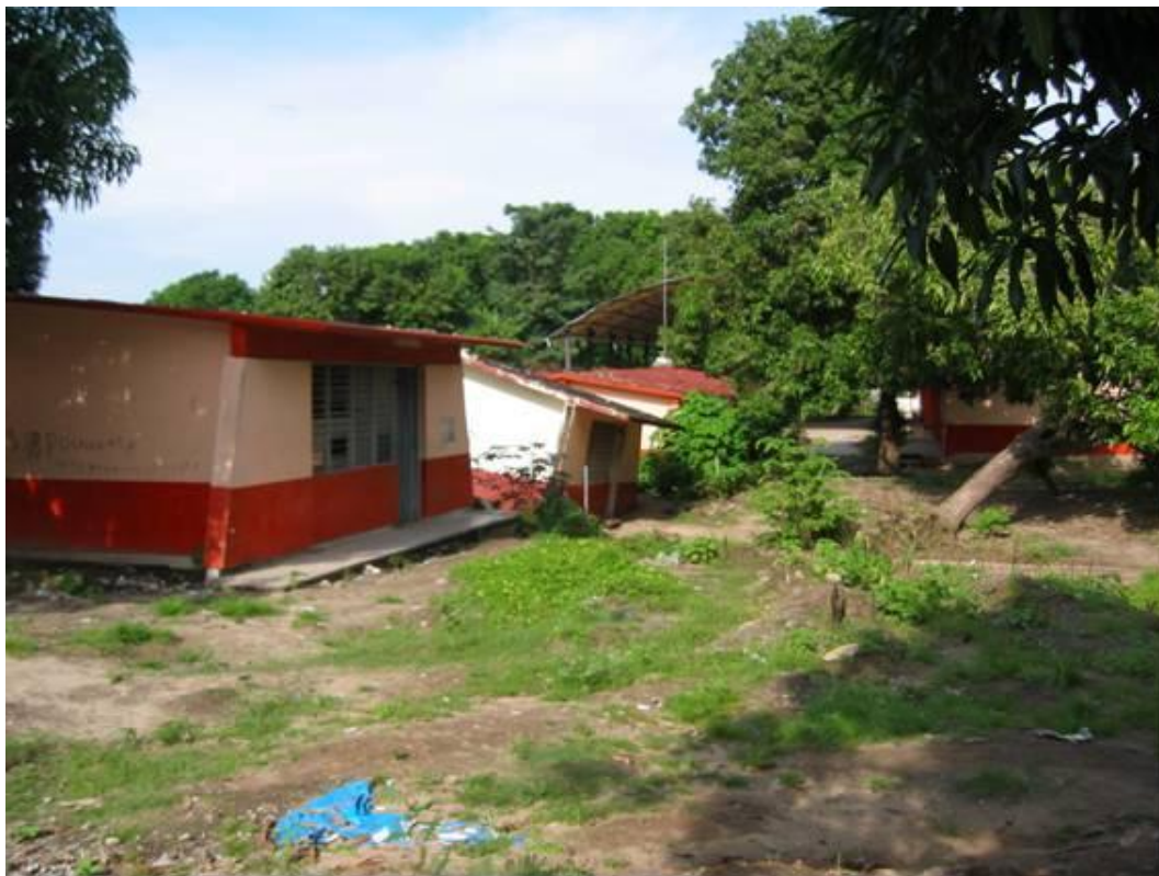
Fotografía 2.72.- Destrucción de la Escuela Primaria Miguel Hidalgo, ubicada sobre la margen derecha del río Huehuetán. Obsérvese el grado de afectación.
