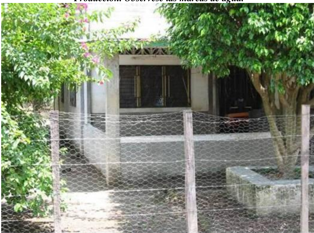
Fotografía 2.38.- Evidencias .de afectación por inundación en el Cantón Nueva Victoria. Obsérvese las marcas de agua en la vivienda.
