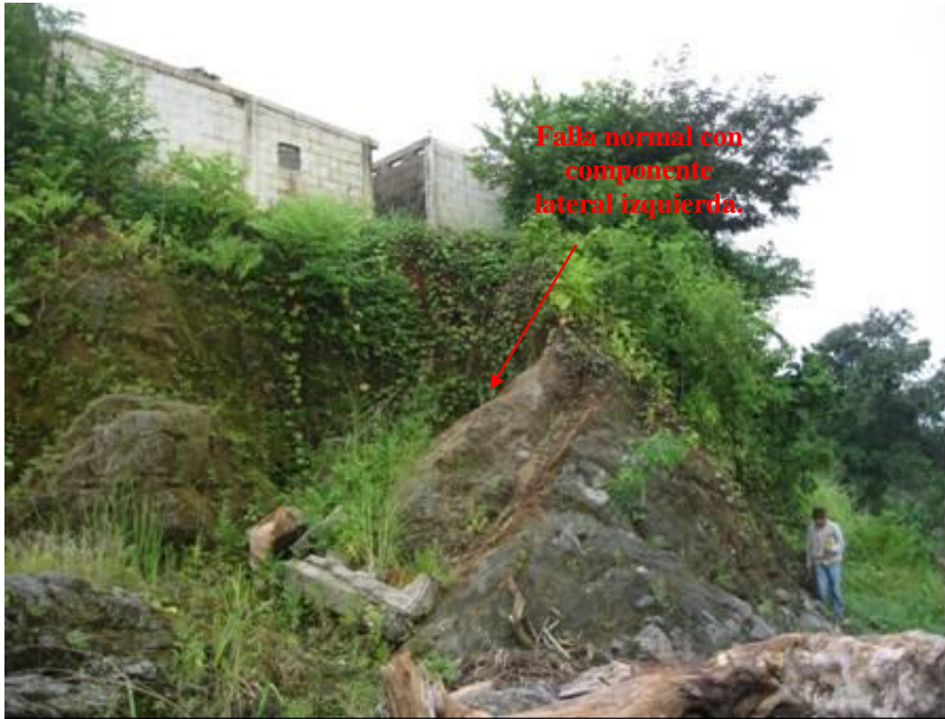
Fotografía 2.3.- Obsérvese daño parcial a una vivienda asentada sobre una falla normal. Antigua Colonia el Recreo.
