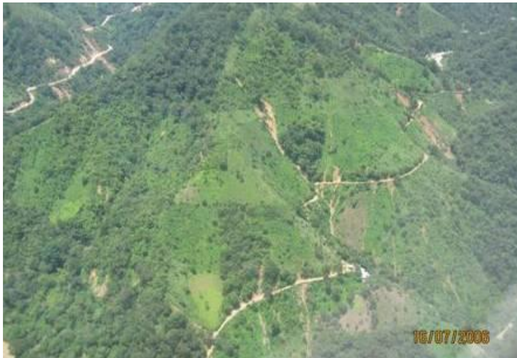
Fotografía 2.21.- Vista Panorámica del cerro Chevolcán, donde se aprecian el factor de deforestación que favorece el origen de los deslizamientos. Localidad de Tolimán, Motozintla.
