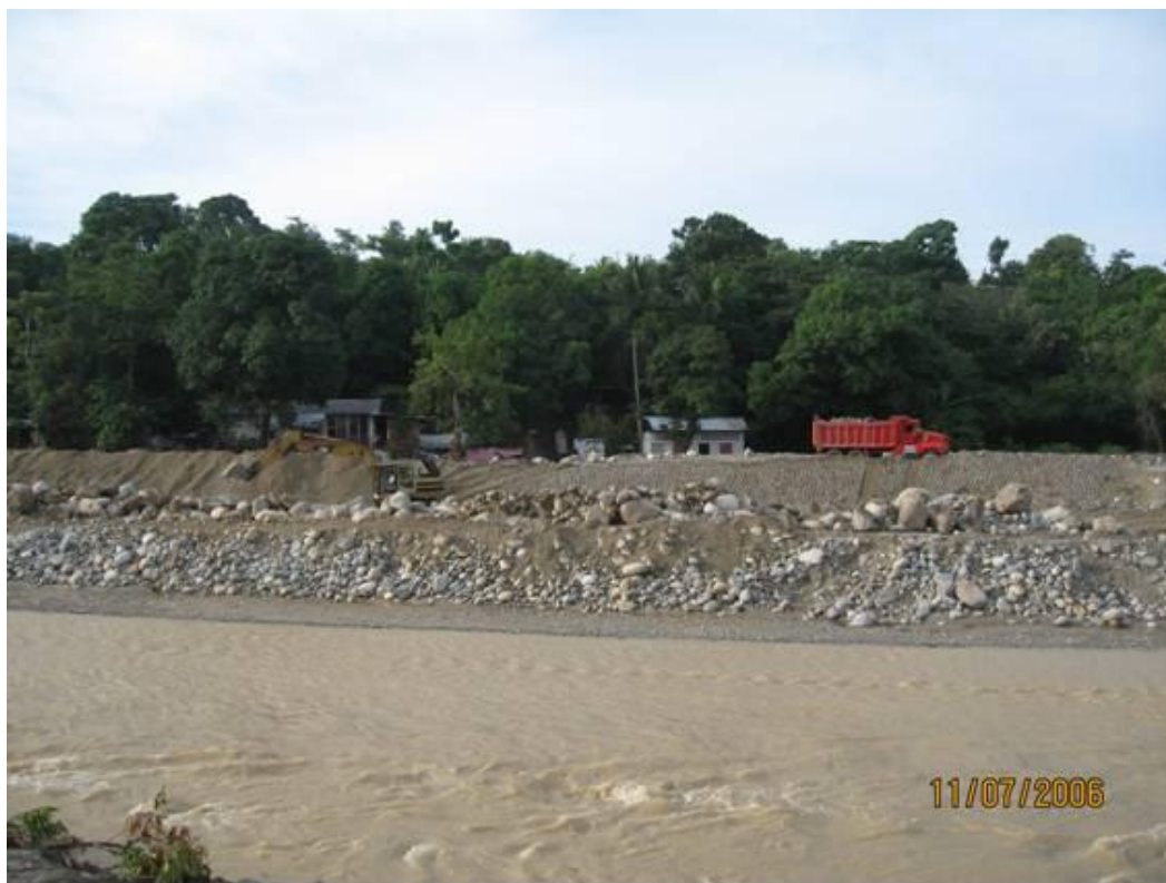
Fotografía 2.37.- Prolongación Av. Central, al fondo se aprecian viviendas en peligro de inundación, actualmente el río pasa por donde fuera la Colonia Callejón del Muro.
