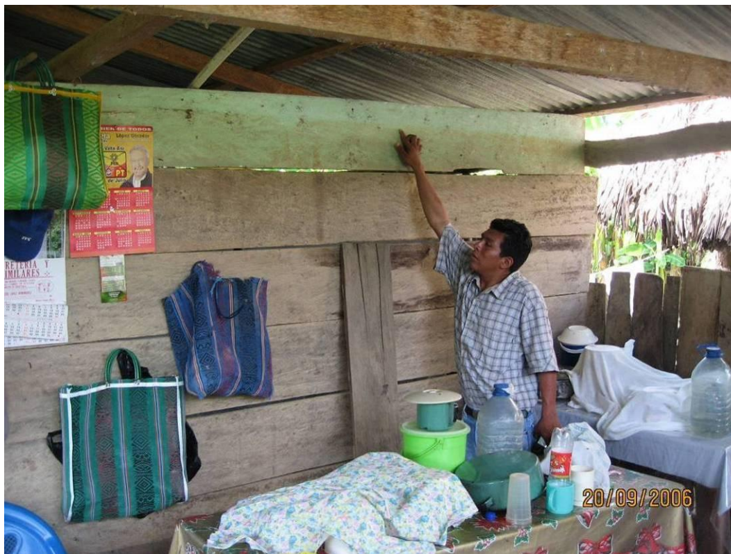
Fotografía 2.51.- Obsérvese el grado de afectación a las viviendas de la localidad Altamira y la alta vulnerabilidad de las mismas asociada a su ubicación y material con que fueron construidas.
