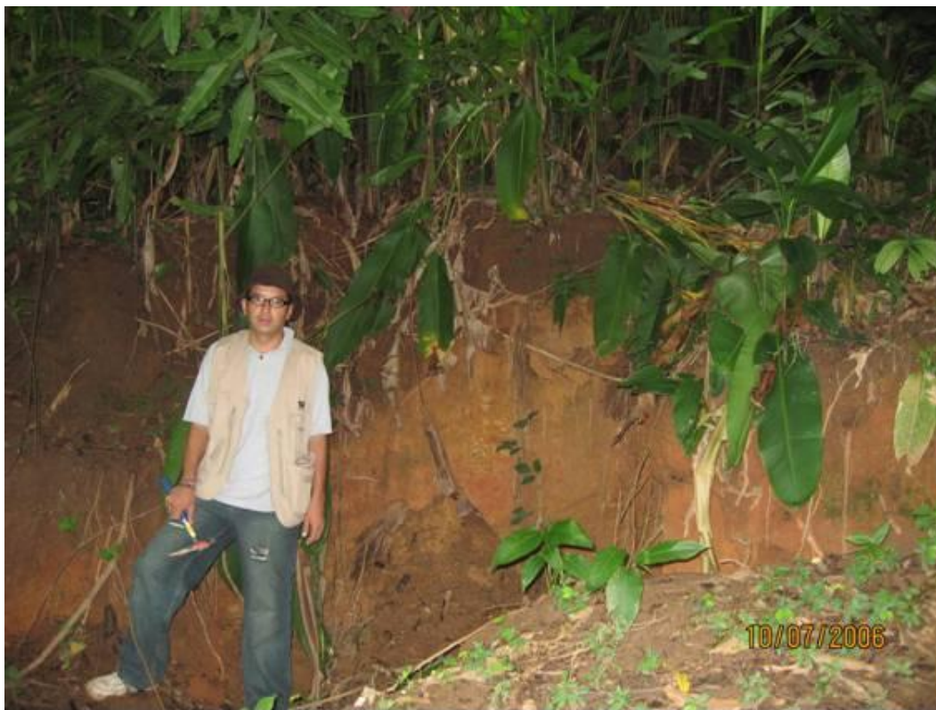
Fotografía 2.17.- Escarpe indicativo de un deslizamiento.
