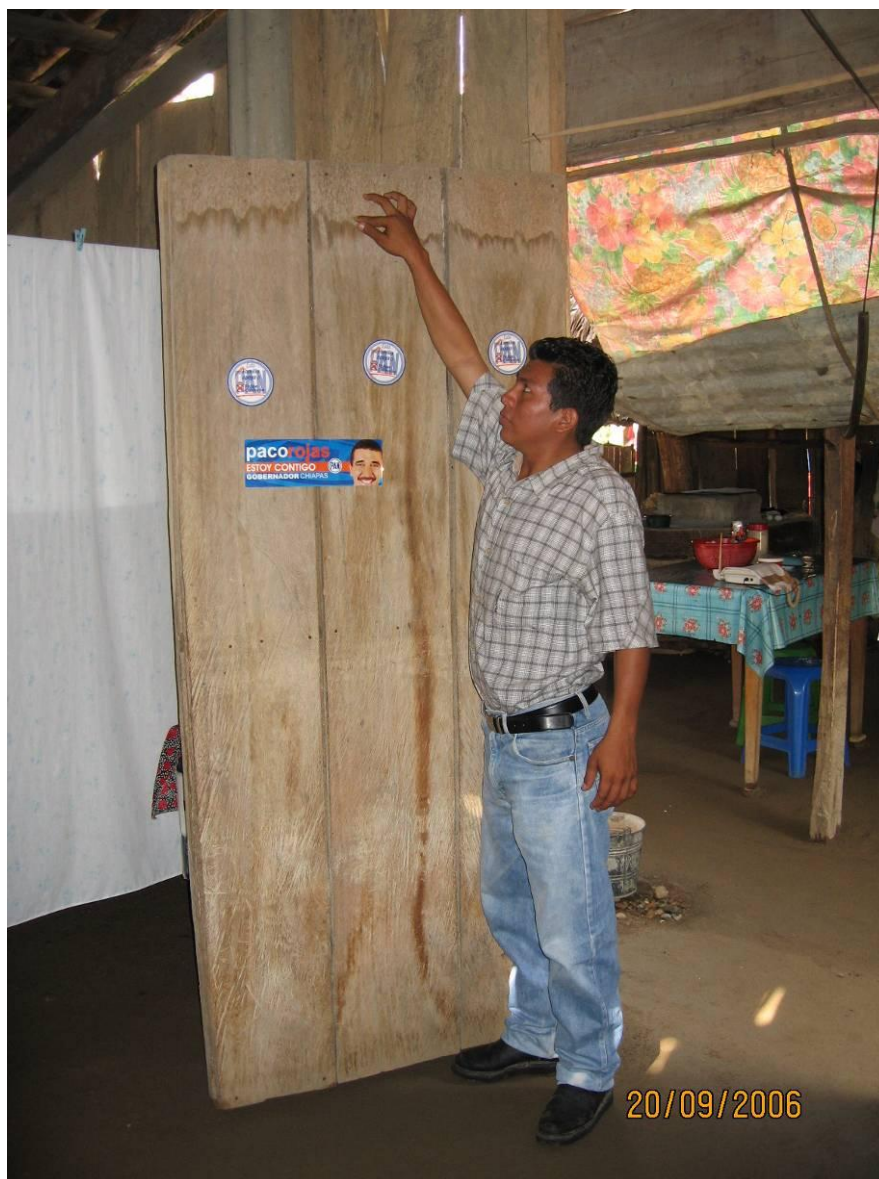
Fotografía 2.52.- Nivel de afectación a las viviendas de la localidad el Tzinacal, observe el tipo de construcción vulnerable por su ubicación y materiales.
