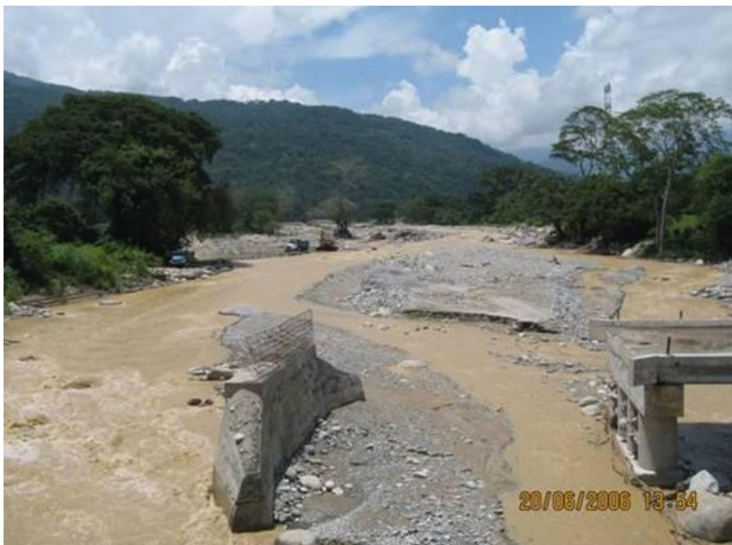
Fotografía 2.46.- Puente del libramiento de la carretera que conduce a Arriaga, destruido por el paso de la corriente del Río Huixtla. Obsérvese la amplitud del Río.
