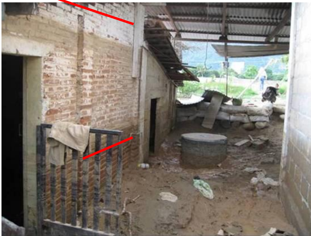
Fotografía 2.42.- Se aprecian las marcas del nivel de agua durante la inundación del Huracán Stan (marca superior) y una inundación ocurrida el día 9 de Junio del presente año.
