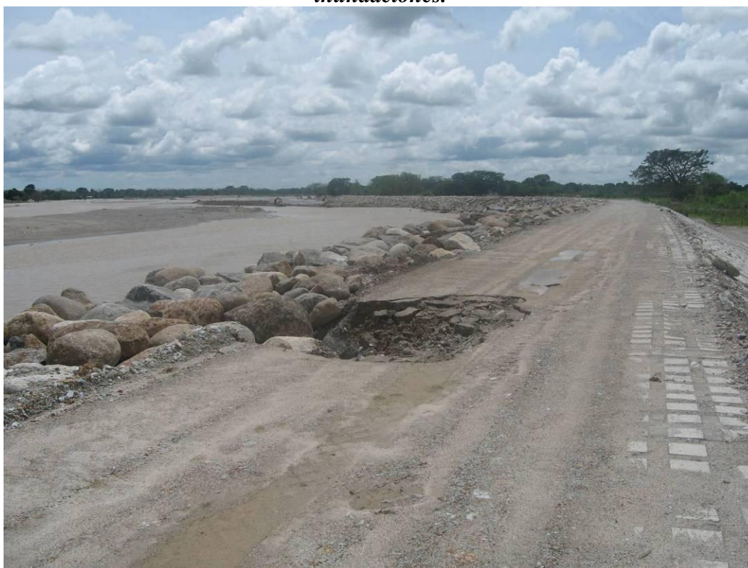
Fotografía 2.50.- En esta zona se observaron algunas deficiencias en la construcción del bordo de contención.
