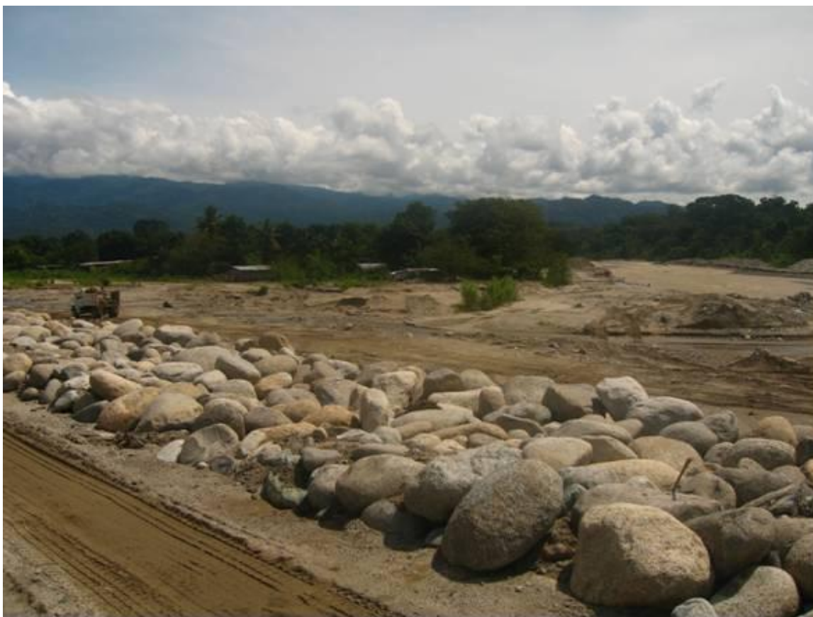
Fotografía 2.33.- Obsérvese la configuración del actual cauce y la construcción del borde de contención dejando dentro del cauce a las viviendas de la Colonia El Chamizal.
