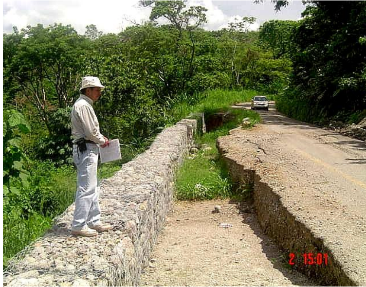
Foto No. 10.- Deslizamiento que afecta el 50% de la carretera, con una longitud de 50 m con un salto de 60 cm. Se reforzó con muros de contención.
