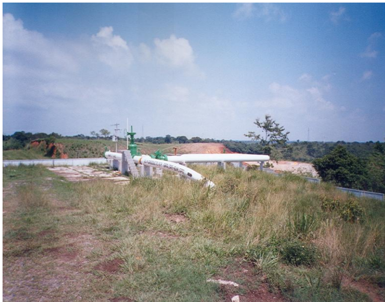
Foto No. 20.-Trampas de envío y de recibo de la batería giralda, al fondo se observa la fosa de los quemadores, se encuentra en buenas condiciones.
