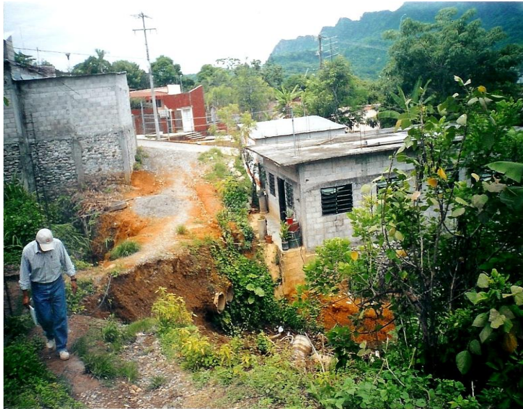
Foto No. 12- Deslizamiento que afecta la calle, tiene una longitud de 5 m y la roca expuesta son lutitas- limonitas, la dirección de sus echados son similares al a dirección del deslizamiento (NW).
