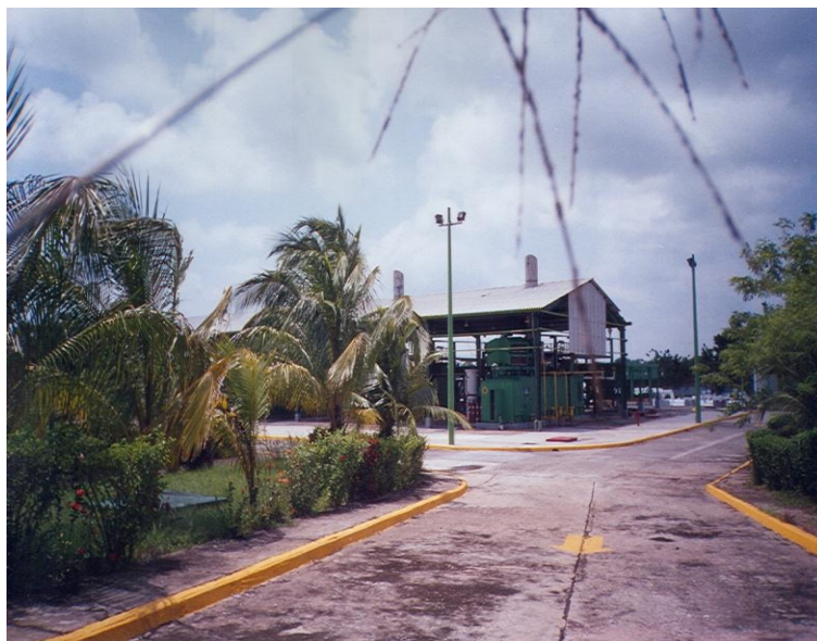
Foto No. 21.- Vista de la zona de la compresora dentro de las instalaciones de la Batería y Compresora Giraldas.
