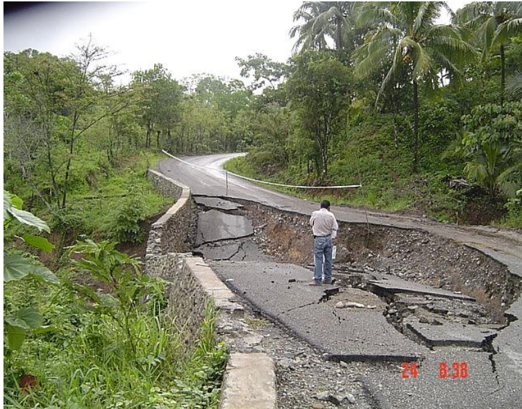
Foto No. 13.- Carretera Pichucalco-Tectuapan, sufrió grandes daños casi en su totalidad por un deslizamiento debido a las intensas lluvias.
