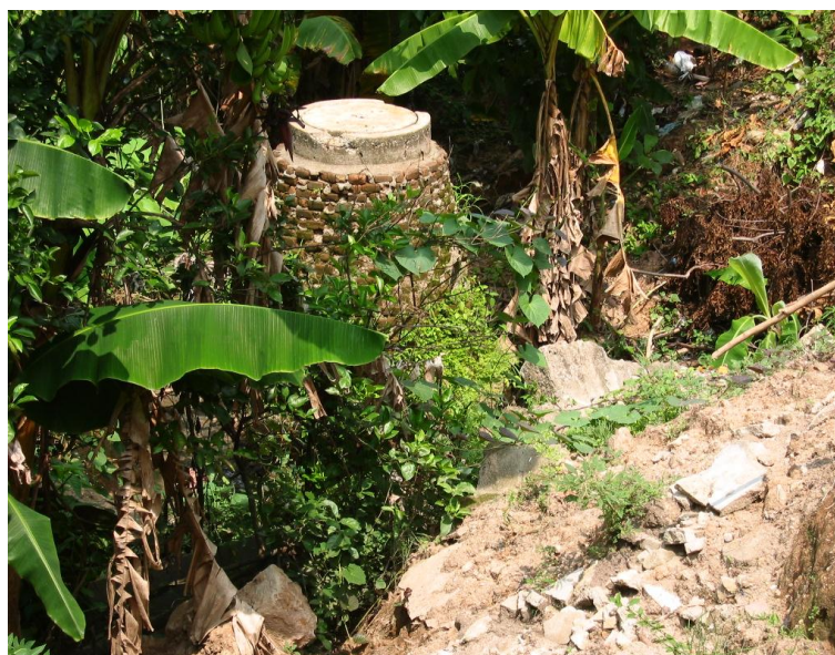
Fotografía 13. Calle Cerrada del Novillero. En este punto se encuentran problemas por inundación en la parte baja, ya que la barda de PEMEX (zona industrial) tapo el paso de la corriente. algunas viviendas ya se han visto afectadas debido a este problema.
