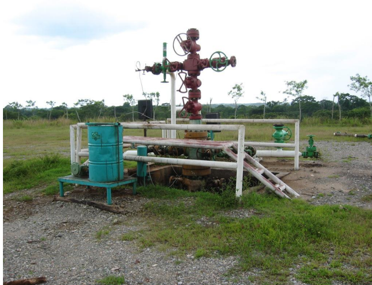
Fotografía 25.- Pozo activo de extracción de gas (REF77), la infraestructura se encuentra algo oxidada, aunque no existen asentamientos cercanos es importante darle mantenimiento.
