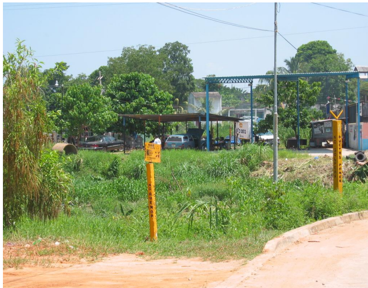
Fotografía 21.- Ductos localizados dentro de la mancha urbana de Reforma.
