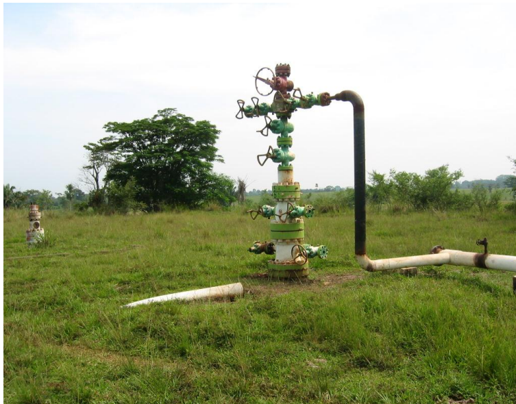
Fotografía 23.- Pozo inactivo con punto de verificación REF122, se observa rodeado por pastizales y sin presencia de asentamientos humanos.
