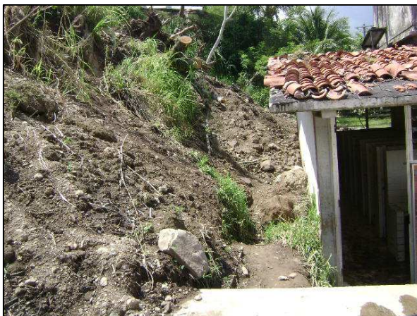
Deslizamientos de tierra en la Escuela Secundaria
