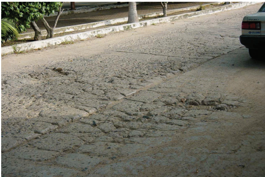
Concreto hidráulico en mal estado, calzada al panteón
