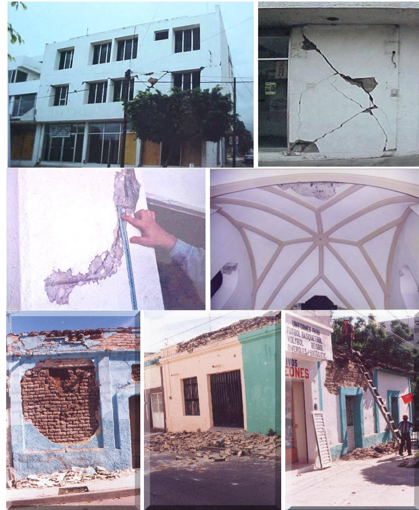
Foto 29. Daños debidos al sismo de Villaflores de 1995 en edificios públicos de Tuxtla Gutiérrez (González et al., 2011a).
