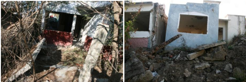
Foto 37. Afectaciones a las viviendas por flujos de lodo en el fraccionamiento Cueva del Jaguar.
