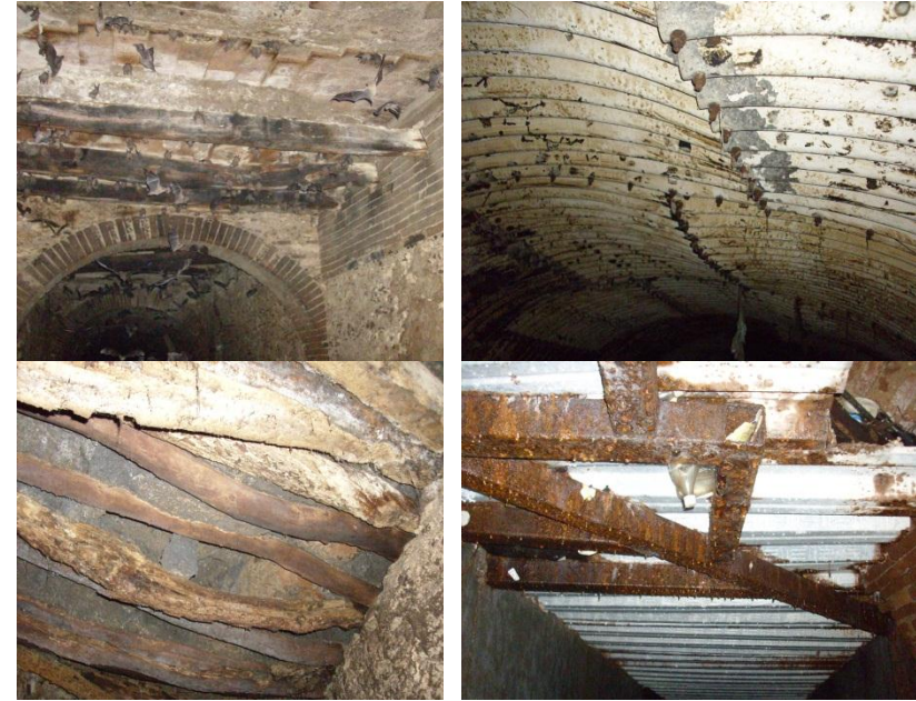
Foto 31. En la Foto 31a. Deterioro en estructura del embovedado de la 4ª Norte y 4ª Oriente. Foto 31b. Corrosión en estructura embovedado de barrio San Roque. Fotos 31c. y 31d. Deterioro y corrosión de estructura del embovedado de la 5ª Poniente a la altura de barrio Guadalupe.
