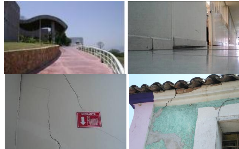
Foto 30. Daños debidos al sismo de las Choapas 7 de abril de 2011 en edificios públicos de Tuxtla Gutiérrez (González et al., 2011b). Foto 30a. Daños en el edificio Corzo. Foto 30b. Hundimiento en rectoría de la Unicach. Foto 30c. Daño en instalaciones de COCYTECH. Foto 30d y 30e. Daño en Hospital de especialidades “ vida mejor ”. Foto 30f. Daño en vivienda de en el centro de la ciudad.
