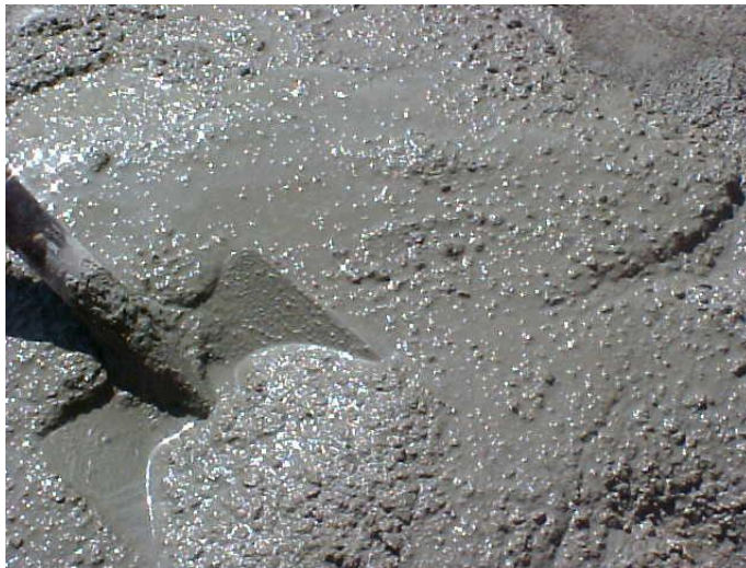
Foto 35. Elaboración de mortero cemento arena con exceso de agua, lo que le provocará fisuraciones y pérdida de resistencia.
