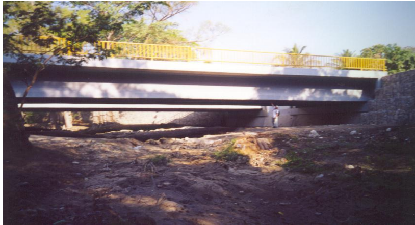
Foto 41. Puente “San José”, que se encontraba en la prolongación de la calzada Conasupo, el cual fue uno de los que fue demolido y reconstruido (tomado de González, 2009).
