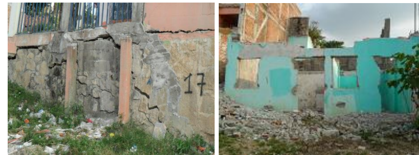
Foto 38. Afectaciones a las viviendas por flujos de lodo en el fraccionamiento Lomas del Oriente.
