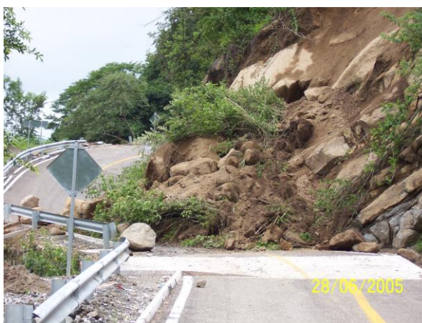
Fotografía 60.- Deslizamiento de masas sobre la carretera en Los Altos de Chiapas
