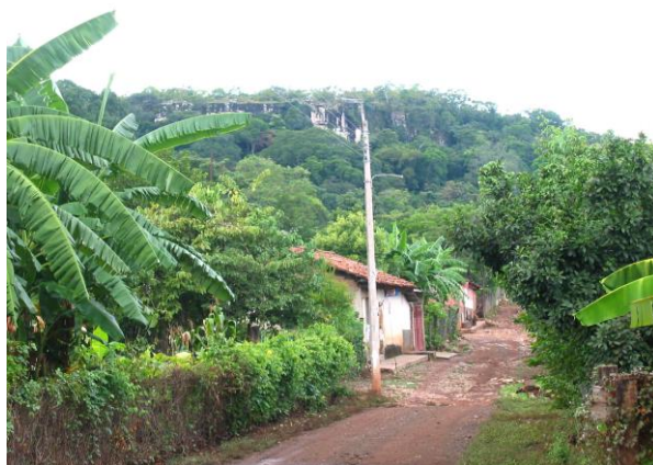
Fotografía 56. En la fotografía se puede observar los escarpes que forma la roca caliza, la cual presenta disolución y fracturamiento, por lo que los bloques han quedado desprendidos y son susceptibles a caer.
