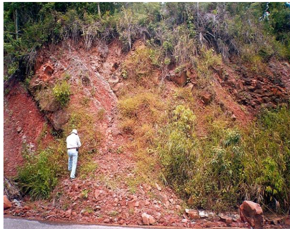
Fotografía 71.- Ranchería Flor de Cacao, municipio de Ocosingo que presenta un deslizamiento de roca que afecta una porción de la carretera.
