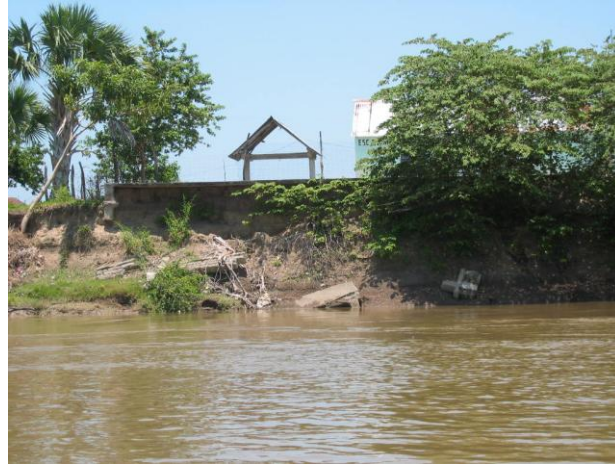
Fotografía 44. Obsérvese el riesgo que implica la erosión que se produce por variación en el nivel del río.
