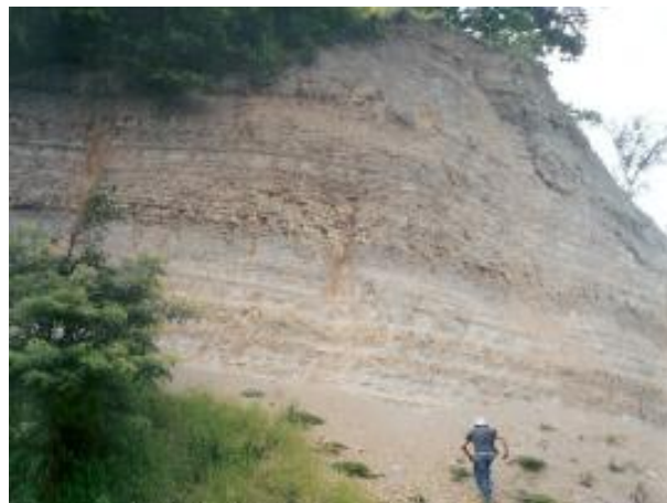
Fotografía 68.- En Playa Larga camino a Antonio León se observa un deslizamiento de material muy inestable.
