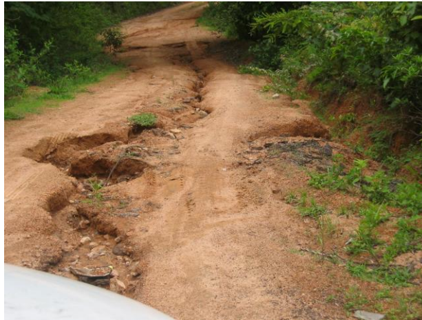
Fotografía 18. Obsérvense los canales que se forman en los caminos, como consecuencia de las precipitaciones intensas en las cercanías de la finca San Rafael.
