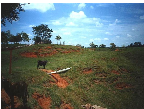
Fotografía 70.- Platanar Abajo 2da Sección-La Peña, deslizamiento ocasionado por erosión antropogénica, quedando al descubierto el oleoducto.
