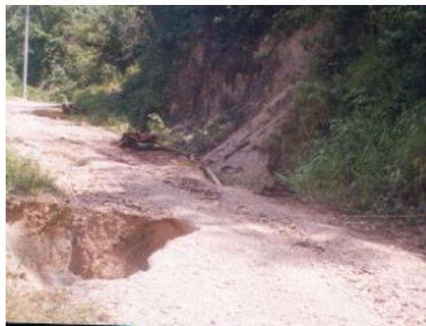
Fotografía 77.- Camino hacia Couitz a la altura de la población Alan Sacjún, en la cual se observan los deslizamientos de suelo producidos por las intensas lluvias.
