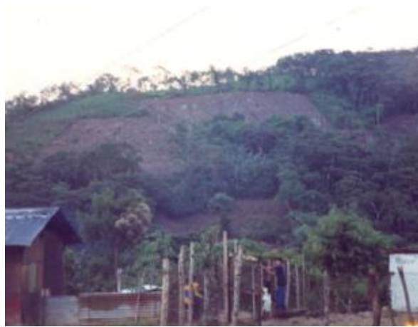
Fotografía 62.- Localidad El Azufre, Huitiupan. Viviendas expuestas a inestabilidad de laderas.
