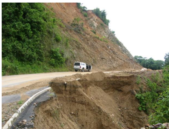
Fotografía 52. Deslizamientos sobre la carretera que va de Ángel Albino Corzo a Siltepec, punto HU126.
