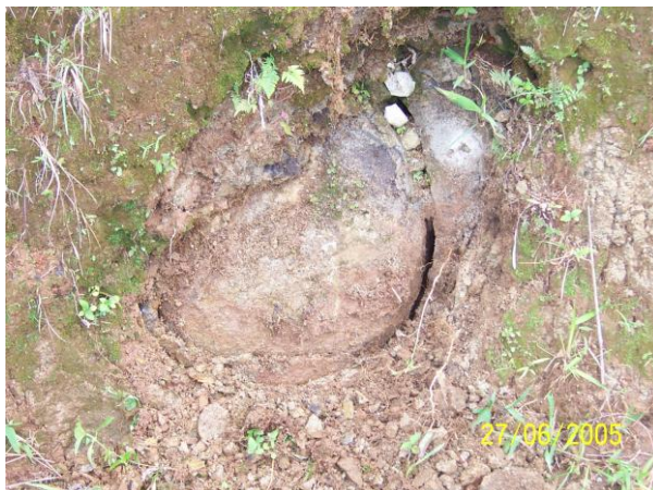
Fotografía 86.- Granito muy alterado, presenta intemperismo esferoidal, originando pequeños deslizamientos de material sobre el camino.
