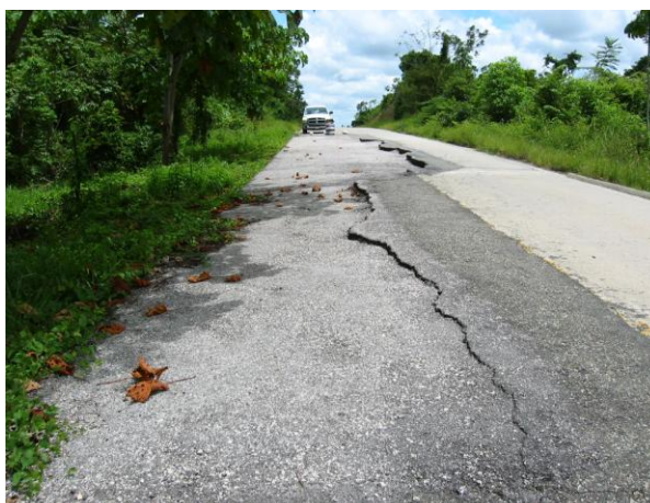
Fotografía 73.- Daños causados al pavimento a causa del deslizamiento de suelo.
