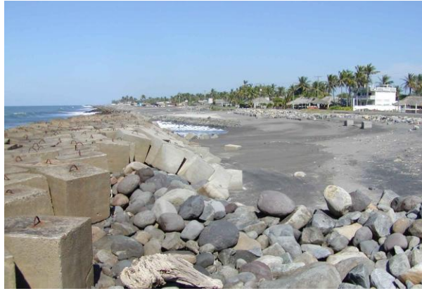
Fotografía 13.- Rompeolas al norte del espigón de acceso al Puerto. Los cubos de concreto representan el último intento por estabilizar la línea de costa.
