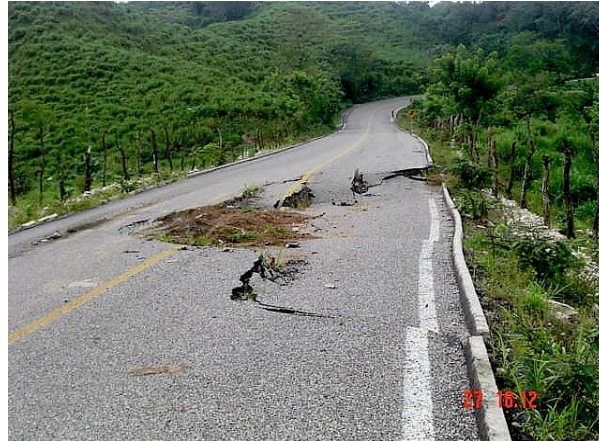
Fotografía 63.- Deslizamiento en la carretera con un salto de 70 cm., la longitud afectada es de 40 m, punto PV022 a 2 km al este de Iscobal.
