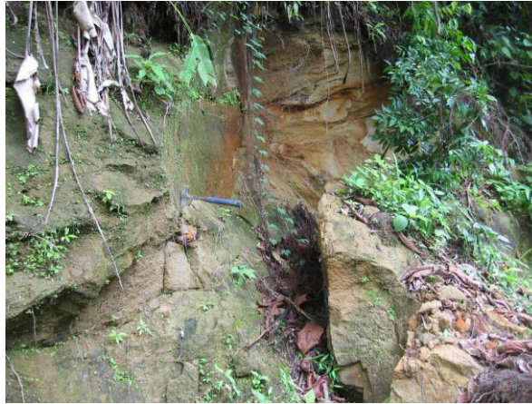
Fotografía 65.- Bloque de grandes dimensiones que se desliza sobre planos de fracturamiento.
