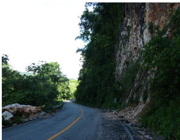
Fotografía 72.- Caída de bloques hacia la carretera, obsérvese que el talud es casi vertical.
